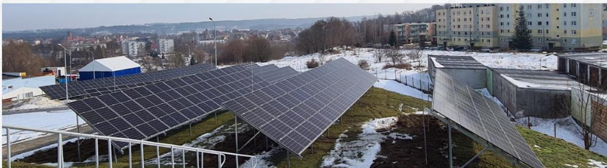
Budowa elektrowni fotowoltaicznej przy Stacji Uzdatniania Wody na osiedlu Mazurskim w Mrągowie
