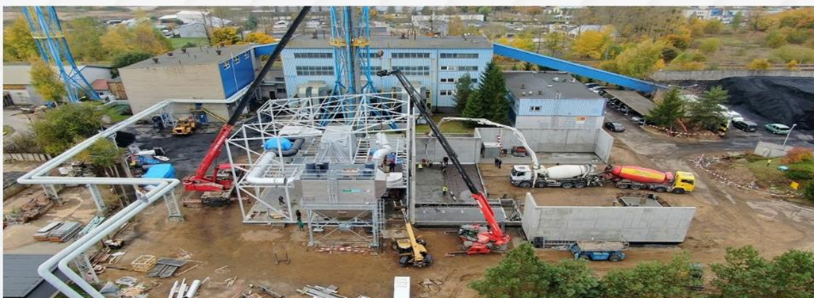
Modernizacja kotłowni rejonowej MEC Sp. z o.o. w Mrągowie - budowa kotłowni bazującej na produkcji energii cieplnej ze spalania biomasy
